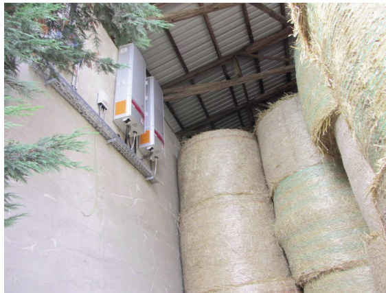
Abb. 10.5.4.1-2: PV-Wechselrichter in einem Strohlager, Quelle: VGH Versicherungen
