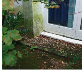
Abb. 6.19: Spritzwasser führte zu Algenbildung und Feuchtigkeit in der Wand im unteren Bereich der Türleibung.
