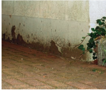
Abb. 6.16: Die Fläche vor dem Gebäude ist versiegelt und neigt sich in Richtung Gebäude. Niederschlagswasser wird nicht vom Gebäude ab-, sondern zu diesem hingeführt.
