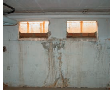
Abb. 6.17: Im Bereich der Kellerfenster bzw. in den Lichtschächten sammelt sich nach Regenfällen Wasser, das nicht abfließen kann, da die Entwässerung der Schächte nicht funktioniert. Das Wasser drückt gegen die Wand und dringt durch eine Stelle in das Gebäude.
