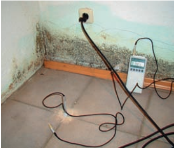
Abb. 6.15: Regenwasser lief über die Treppe in Richtung Eingangstür einer Souterrainwohnung und unter dem Türrahmen in den Fußboden. Es kam in allen Räumen zu Schimmelpilzbefall im Fußboden und auf allen Wänden nahe dem Fußboden.
