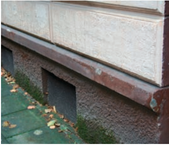
Abb. 6.18: Spritzwasser gegen die Fassade führte zu sichtbarem Algenbefall außen und einer Wanddurchfeuchtung.
