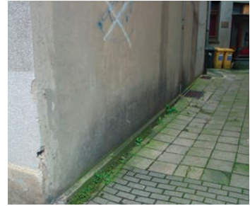
Abb. 6.20: Sichtbare Auswirkungen von Spritzwasser auf der Wand
