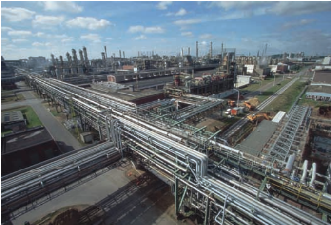
Abbildung 1-1 Rohrleitungen im Chemiapark Marl
