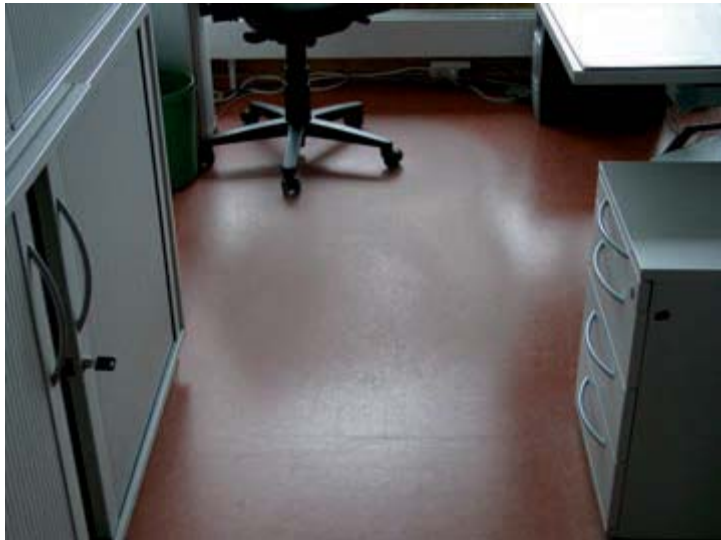
Abb. 5.4.20/1: Verschleiß von einem PUR-vergüteten Belag
