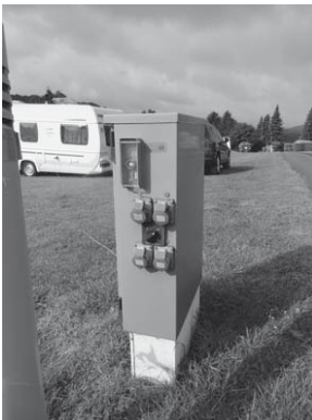
Bild 9.2 Verteiler auf dem Campingplatz für vier Stellplätze
